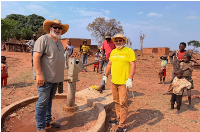
Na 6 jaar weer water uit een pomp in het dorp Chipando
